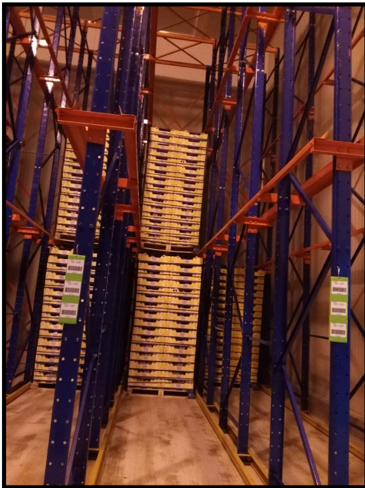
Cámaras de frío
