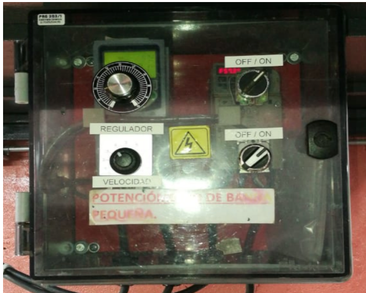
Figura 59 Variador de frecuencia instalado.
