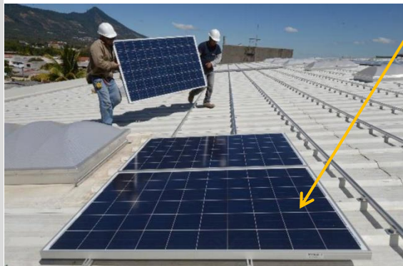
IMG#516 Paneles fotovoltaicos
