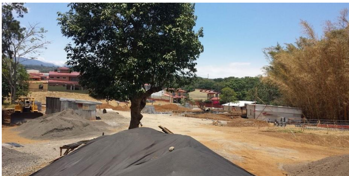
Figura 22: Movimientos de Tierra, Antiguas instalaciones, 2014. Fuente: Memoria institucional período 2011-2016 del Colegio Técnico Profesional San Pedro de Barva, página 32.
