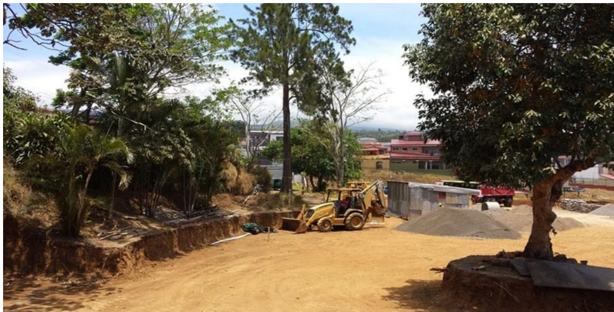
Figura 23: Movimientos de Tierra, Antiguas instalaciones, 2014. Fuente: Memoria institucional período 2011-2016 del Colegio Técnico Profesional San Pedro de Barva, página 33.
