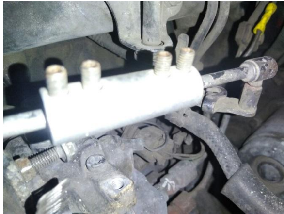
Figura 17 Implementación de sistema mecánico para uso en caso de fallas
