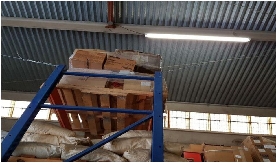
Figura 53 Sujeción de los racks
