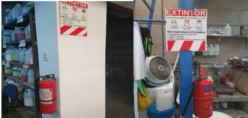
Figura 61 Extintores Ferva del Norte S.A.
