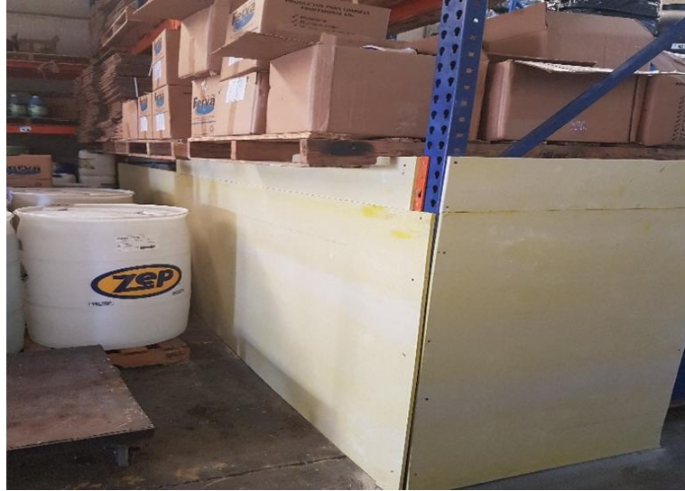
Figura 42 Pared de la bodega de producto terminado.
