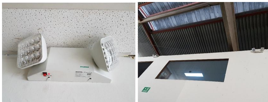
Figura 62 Lámparas de emergencia Ferva del Norte S.A
