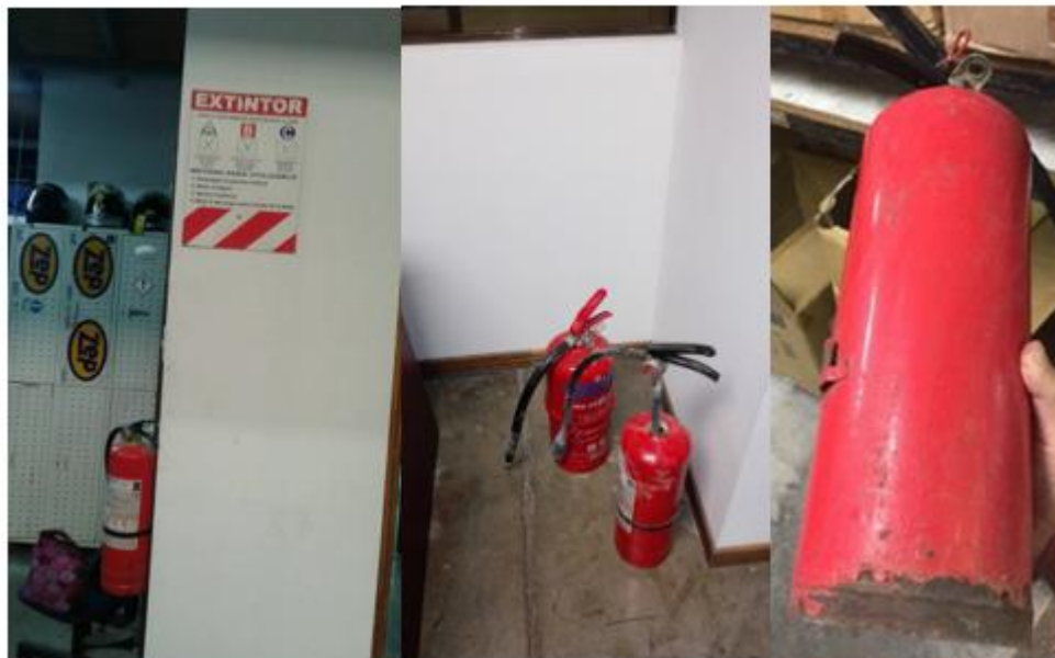
Figura 29 Extintores Ferva del Norte S.A.
