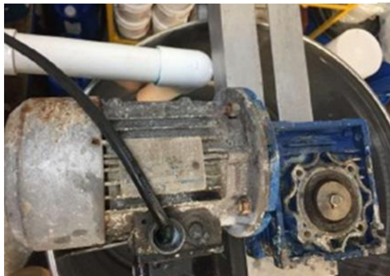
Figura 28 Motor de la Mezcladora Ferva del Norte S.A.
