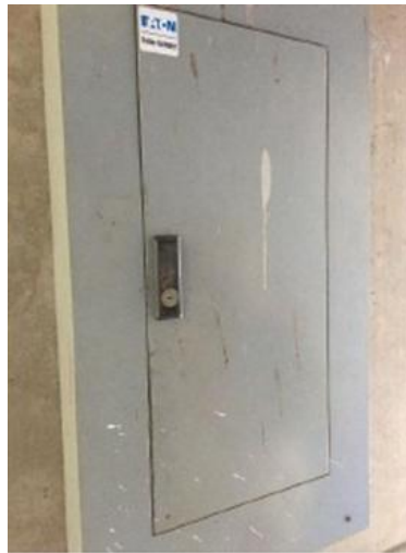
Figura 9 Tablero Eléctrico en Ferva del Norte S.A.
