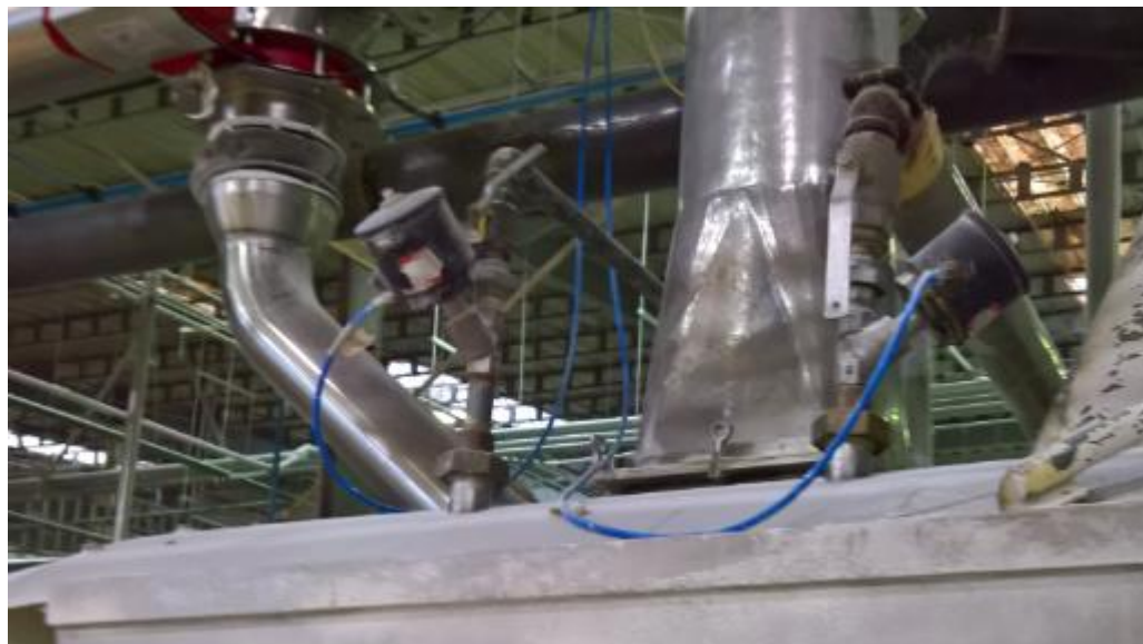
Figura No.24, Imagen de tuberías con polvo de harina y azúcar
