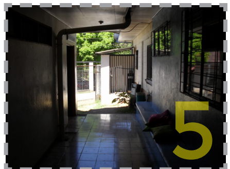
CILINDRO DE GAS EXPUESTO Y SIN MEDIDAS DE SEGURIDAD
