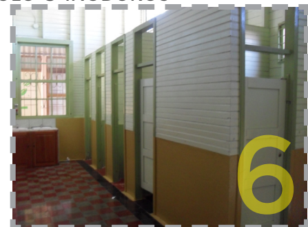
SOLO UNA BATERÍA DE BAÑOS MIXTA Y CON SOLO 5 INODOROS
