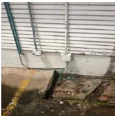
Fig. #6 Puesta a Tierra inadecuada
