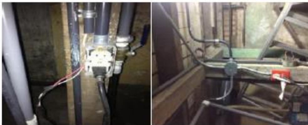
Fig. #2 Empalme mal efectuado y conductor sin protección
