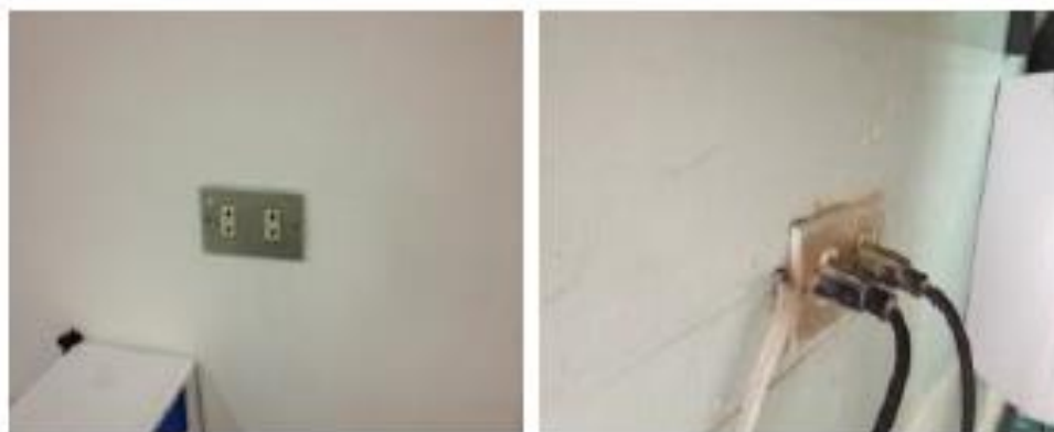
Fig. #5 Tomacorrientes no aterrizados
