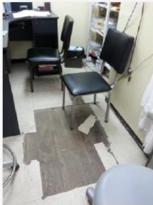
Estado del Recubrimiento de Pisos
