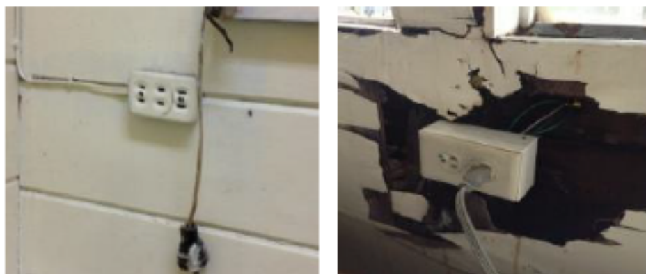
Fig. #9 Tomacorrientes instalados
